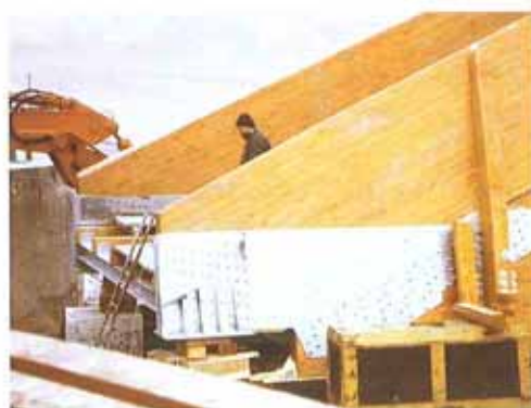
FIGURA 3. Unioni di questo tipo rendono indispensabili accurate opere di protezione del legno in assenza delle quali l'acqua, incanalata all'interno della scatola metallica, ivi rimane, causando il rapido e sicuro degrado biologico del materiale.
